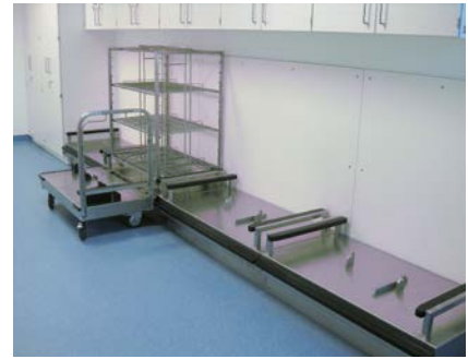
Sterilgutlager mit Elementen des Hammerlit Shuttle-Systems
